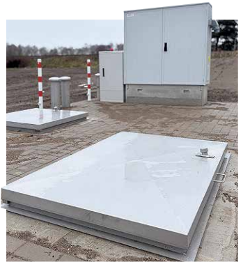
Zu sehen ist von dem neuen Pumpwerk fast nichts. Die gesamte Technik ist unterirdisch verbaut.
