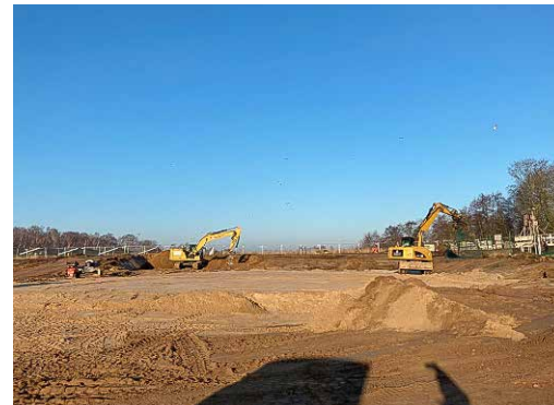
Die Bagger haben ganze Arbeit geleistet und das Baufeld für Abschnitt 2 freigemacht. Hier wird nun die neue Anlage zur Schlammbehandlung errichtet.
