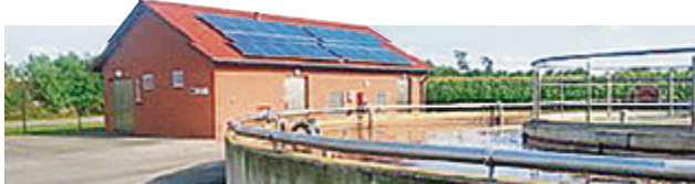
Photovoltaik an der Kläranlage Severin.
