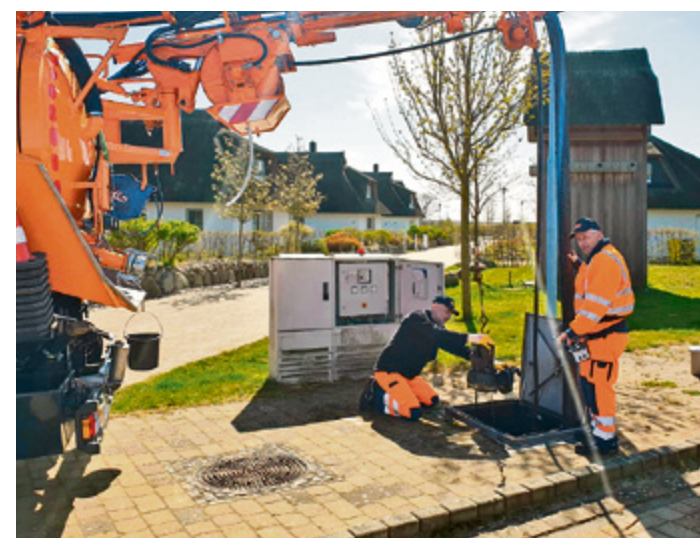
Das neue Fahrzeug erleichtert Mario Guddat (l.) und Carsten Wieck auch die Wartung an diesem Pumpwerk in Zinnowitz.
